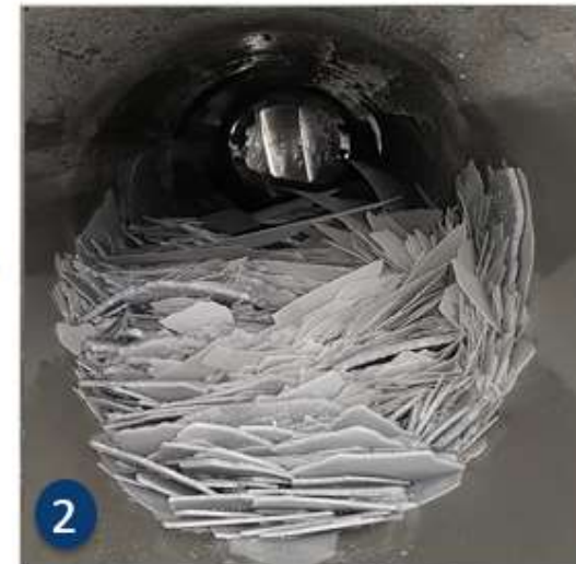
Aufnahme Rohrleitung nach einer Absperrklappe
