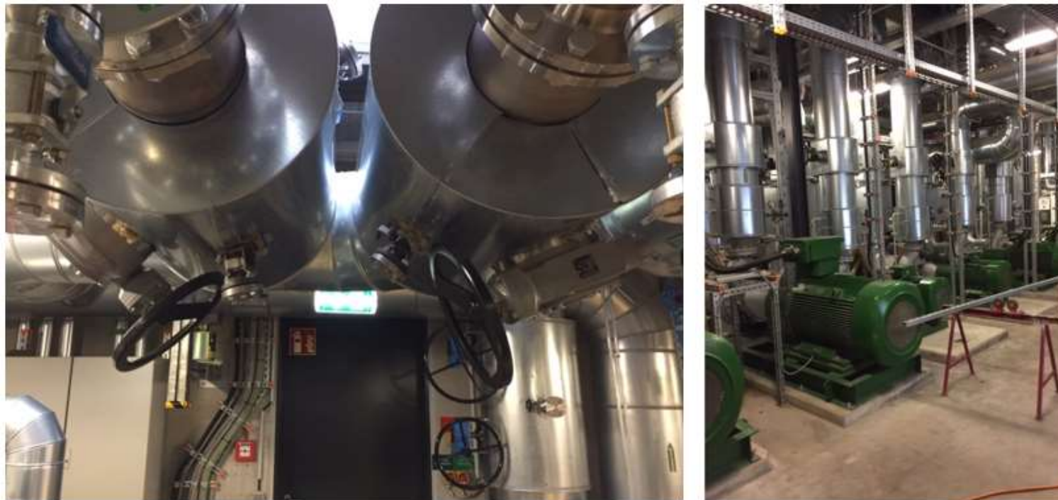
Armaturen verschiedene Nennweiten für Fernwärmewasser 120°C, PN25 in der Pumpenstation
